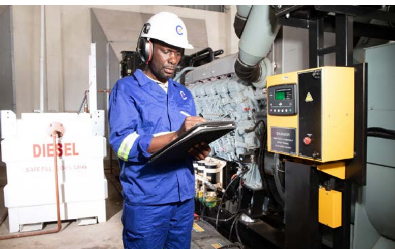
Ein Anlagenbetreiber im Diesellochwerk Mapanga von EGENCO Kraftwerk in Blantyre, Malawi.
